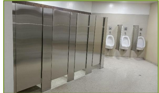
Ilustración 10. Batería Sanitaria sala espera Terminal Satélite del Sur
